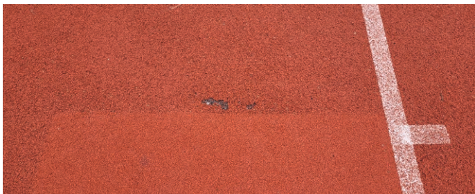
Bestand – Nahaufnahme der porösen, sanierungsbedürftigen Allwetterplatzfläche
