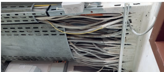
Aktuelle Bilder überfüllter Kabeltrassen und -stränge
