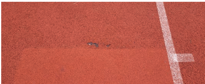
Bestand – Nahaufnahme der porösen, sanierungsbedürftigen Allwetterplatzfläche
