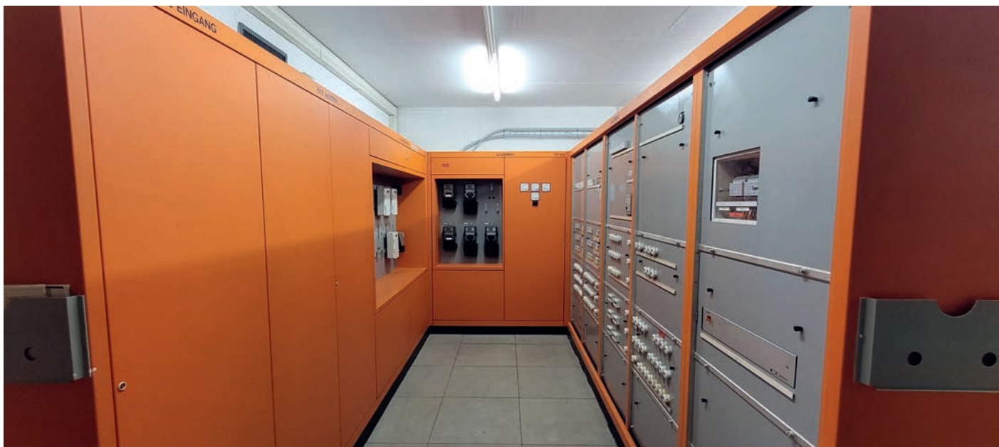
Teil der originalen Elektro-Hauptverteilung im Üdiker-Huus; Baujahr 1978
