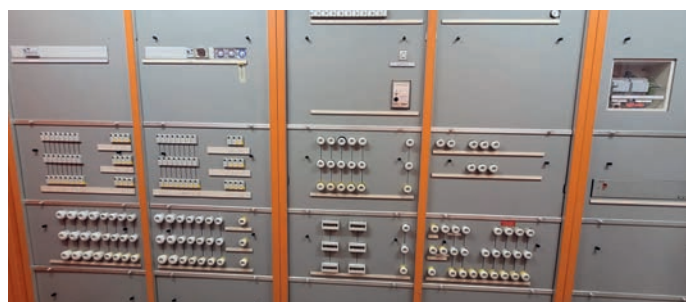
Aktuelle Bilder Hauptverteilung und Sicherungen
