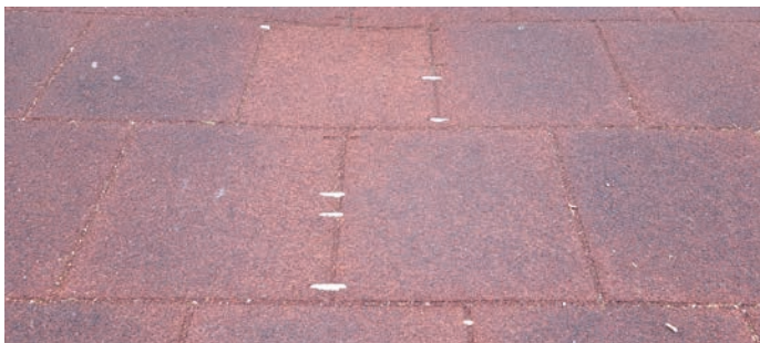
Bestand – Nahaufnahme unebener, stark abgenutzter Fallschuttmatten des Spielplatzes
